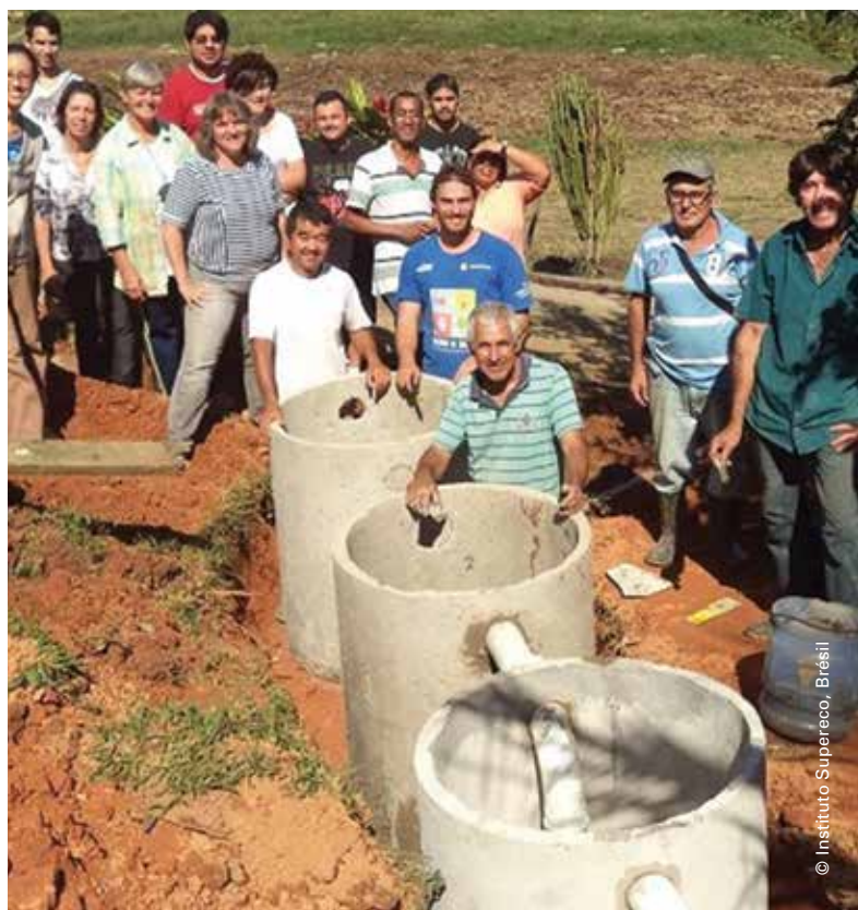
Communauté travaillant à une usine de bio-gaz à Caraguatatuba
