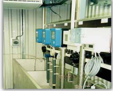
■ الصورة ٧: داخل محطة لرصد نوعية المياه في سوريا.
